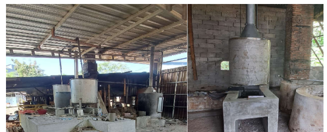
Gambar 5. Penerapan Boiler di Mitra 1 dan Mitra 2
